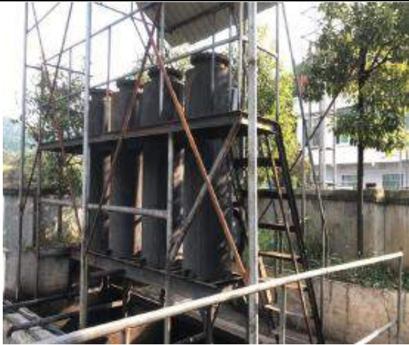
生产废水处理设备
