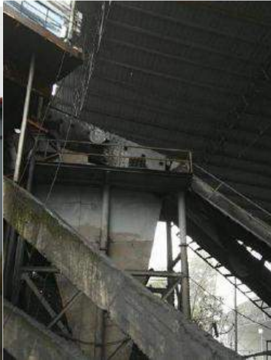
堆场喷淋装置及钢架棚
