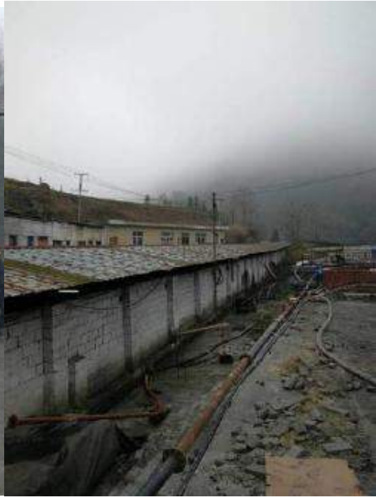
封闭式皮带运输
